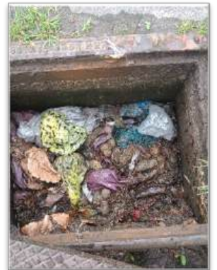
Afval in een rioolput...
